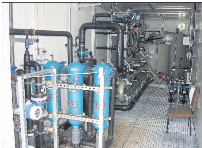
Blick auf den biologischen Teil der Sickerwasserbehandlungsanlage
