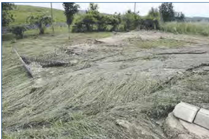
Beschädigte Zaunanlage durch Niederschlagswasser
