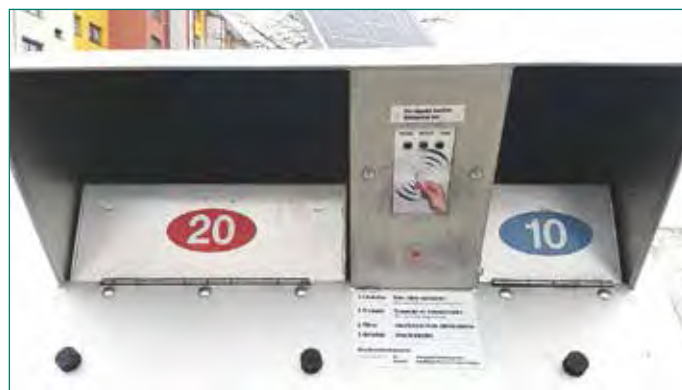
Müllschleuse in Pößneck-Ost
