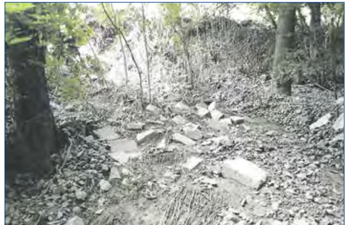
Große Geröllmengen im Auslaufbereich, ausgespülter Steinschüttdamm
