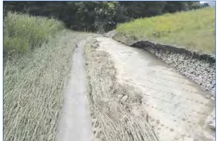
Schotterkeil erodiert, Beton-Gerinne unterspült, Rasengittersteine verschoben und freigelegt
