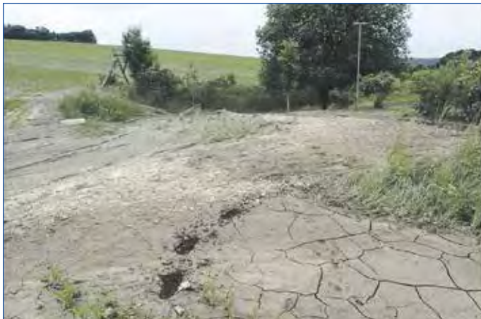
Größere Schlamm- und Geröllmassen haben den Zaun komplett niedergedrückt
