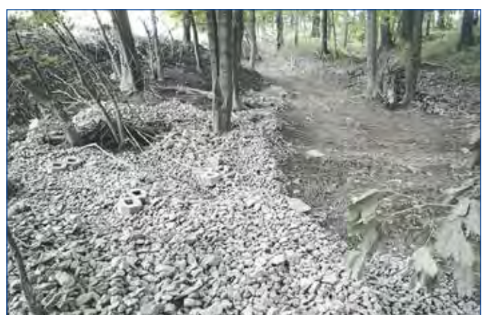
Reste Schottermaterial und Rasengittersteine der Gerinnebefestigungen unterhalb der Deponie
