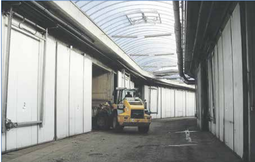
Blick in die Fahrgasse mit rechts und links angeordneten Rottetunneln
